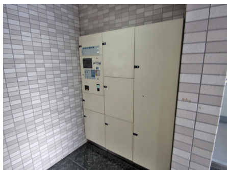
宅配ボックス
