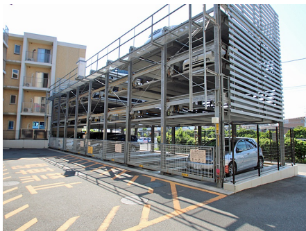
機械式駐車場
