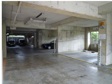
屋内機械式駐車場
