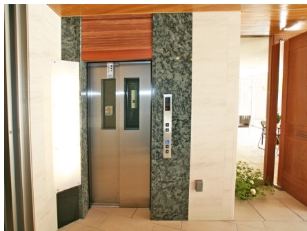
エレベーター
