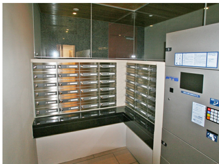
宅配ボックス
