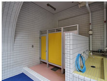
共用シャワールーム
