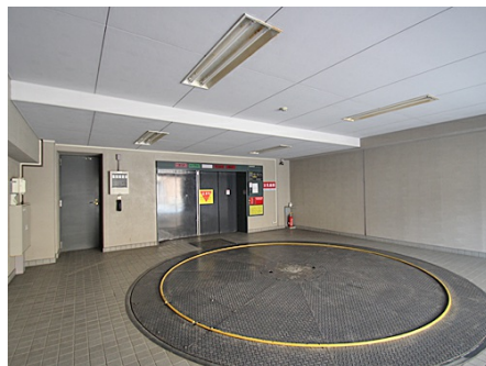
機械式駐車場
