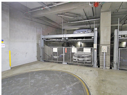
機械式駐車場
