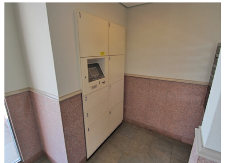
宅配ボックス
