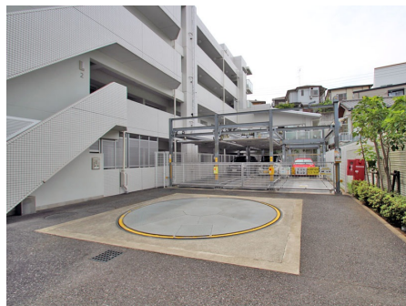
機械式駐車場
