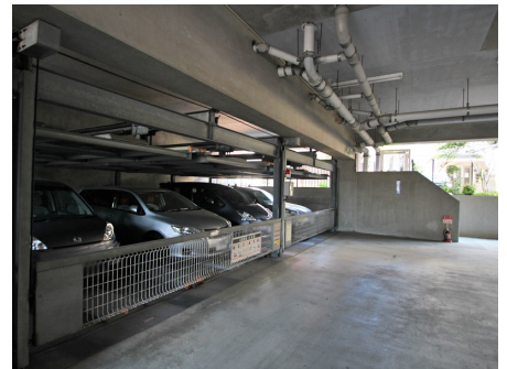
機械式駐車場
