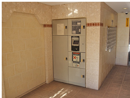
宅配ボックス
