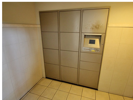
宅配ボックス
