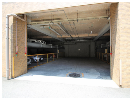
機械式駐車場
