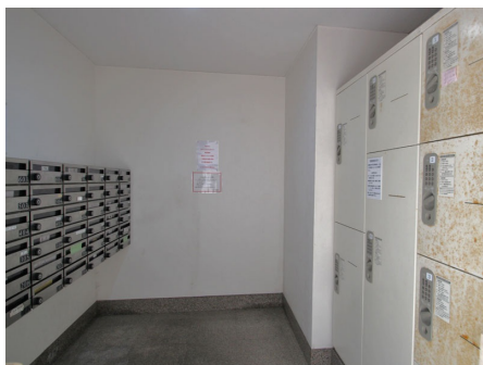
宅配ボックス
