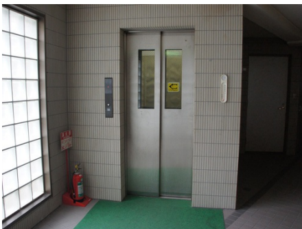
エレベーター
