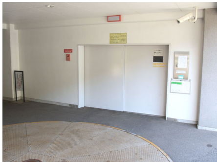
機械式駐車場
